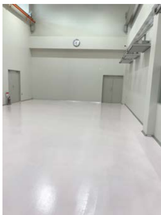
写真 1. クリーンルーム
